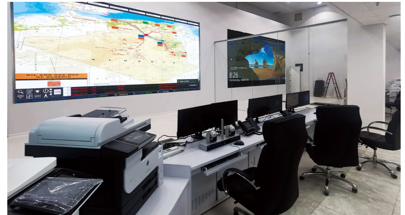
阿尔及利亚 SCADA 项目 The SCADA project in Algeria
